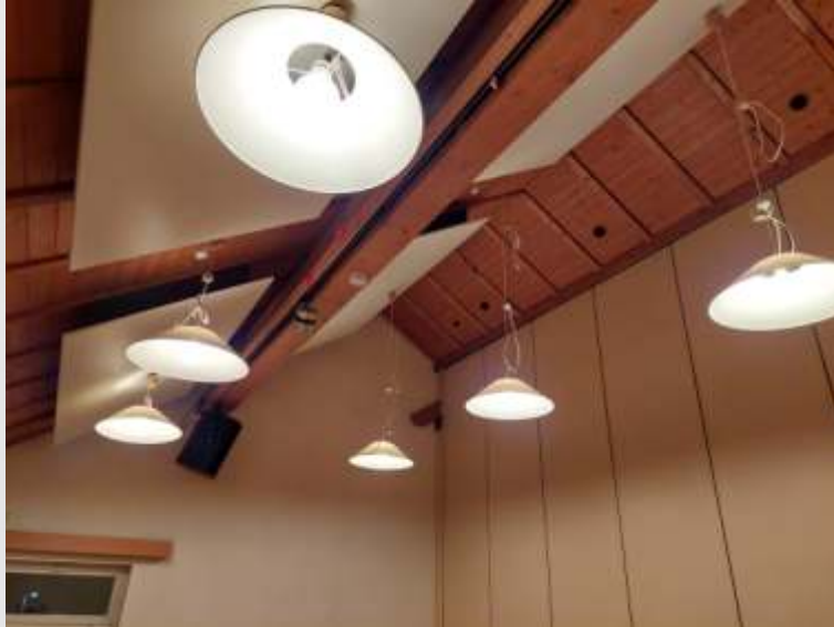
Großer und Kleiner Saal OG – ALT: Alte Lampen-technik mit hohem Verbrauch und schlechter Lichteffizienz.
